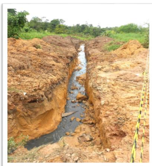
Foto 17 - Esgoto a céu aberto nas proximidades de Abacatal. Fonte: Acervo da pesquisa, 2015.
